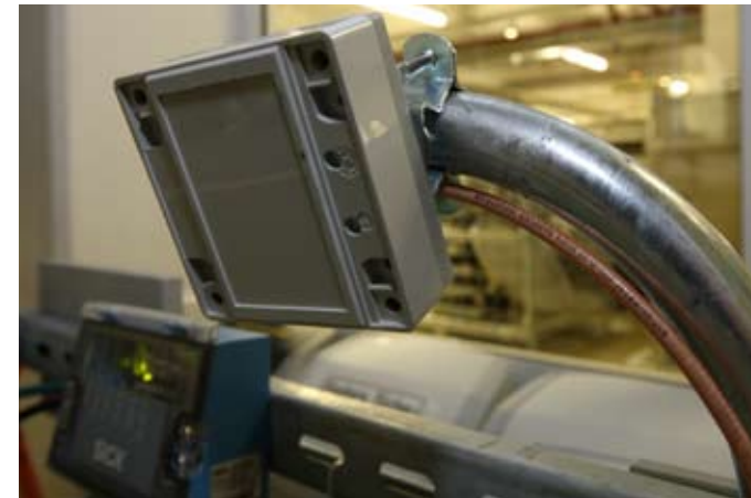
RFID-Spezialantenne und Barcodelesung an der Fördertechnik
